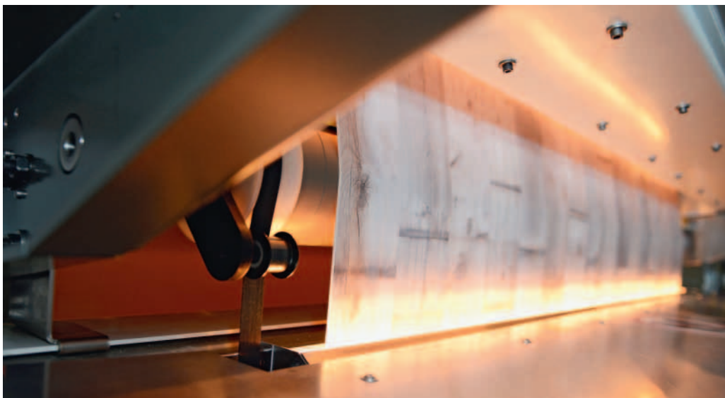
Für die einseitig bedruckten Dekorpapierbahnen werden Hybridtrockner – Infrarot plus Warmluft – eingesetzt.
